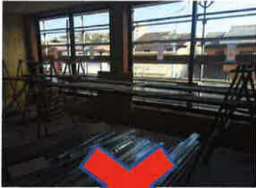
悪い事例 うま足場2点支持
